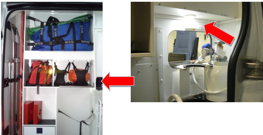
Rys. 34. Oświetlenie LED przedziału technicznego
