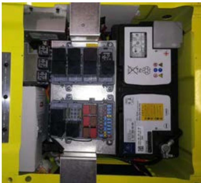
Rys. 7. Umieszczenie akumulatora dodatkowego z etykietą informującą
