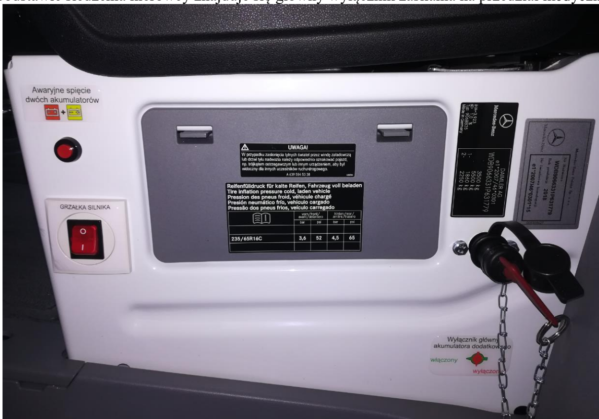
Rys. 13. Wyłącznik akumulatora dodatkowego
