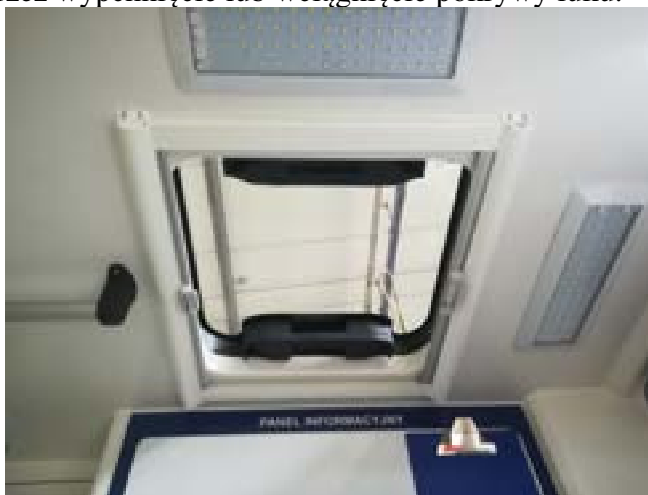
Rys. 54 Luk dachowy manualny zamontowany w przedziale medycznym
