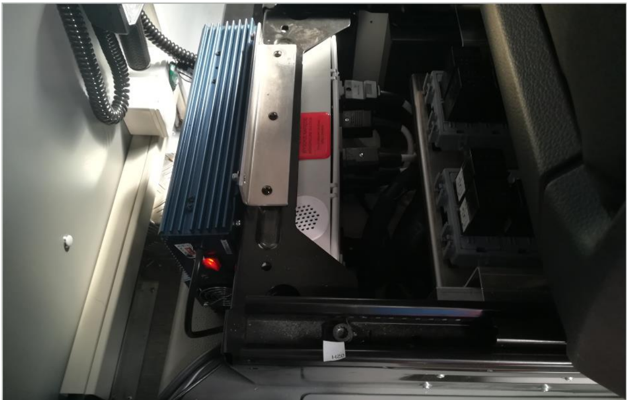
Rys. 8. Umieszczenie ładowarki akumulatorów
