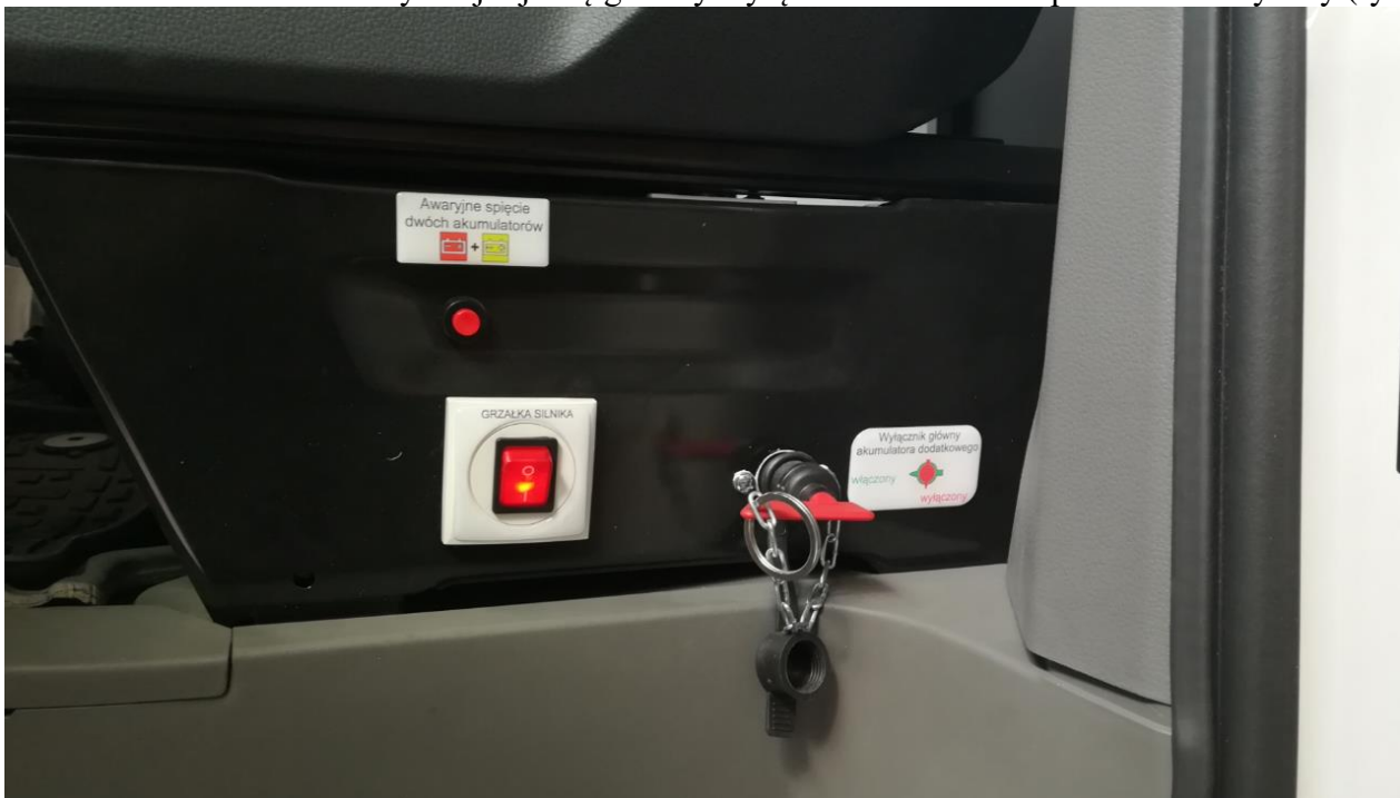
Rys. 13. Wyłącznik akumulatora dodatkowego
